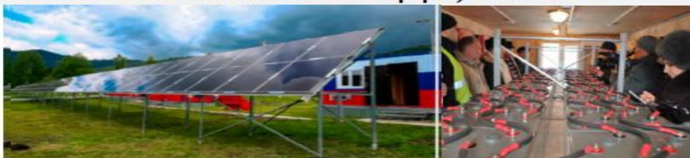
Автономная СЭС, 100 кВт, с. Яйлю, Республика Алтай, 2013.
