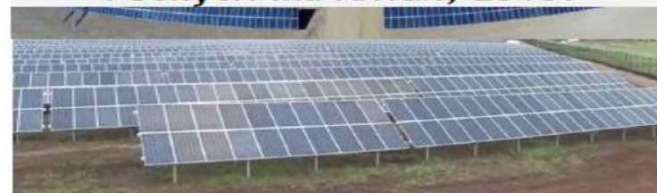
Переволоцкая СЭС, 5 МВт, Оренбургская обл., 2015.
